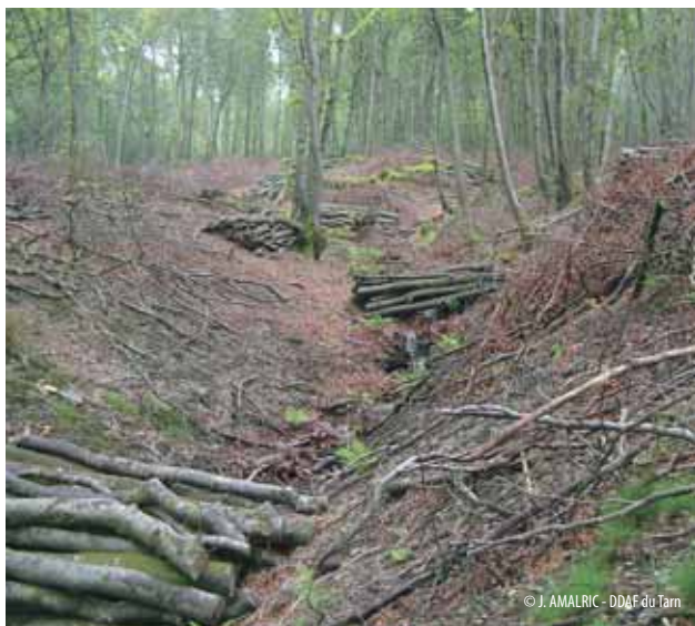
Des bois coupés sont stockés à proximité du cours d'eau ou en secteur inondable
