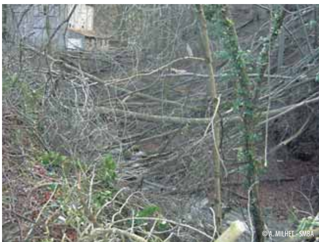
Des arbres, des branches encombrent le lit du cours d'eau
