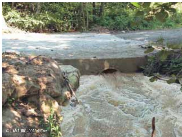
Des ouvrages de franchissement des cours d'eau sont inadaptés ou hors gabarit
