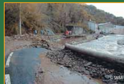
Dégâts routiers sur l'Arnette
